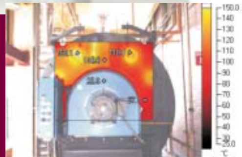
Termografía de una Caldera (Pérdida de Calor)
