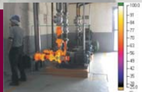
Termografía en Tuberías No Aisladas
